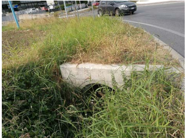
FOTO 8: tratto terminale tombinatura fosso sud via Emilia CLS DN1000 e inizio tratto a cielo aperto
